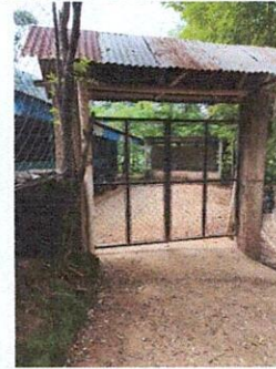
Foto 2: portón de malla deteriorado
