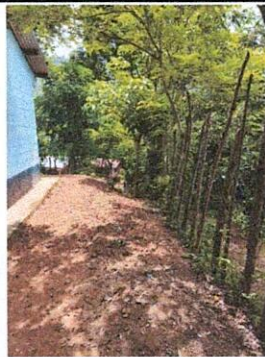
Foto 3: Parte trasera del muro perimetral, malla caída y en mal estado
