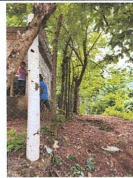
Foto 4: parte lateral con la malla en mal estado
