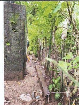
Foto 6: parte lateral malla caída e insegura
